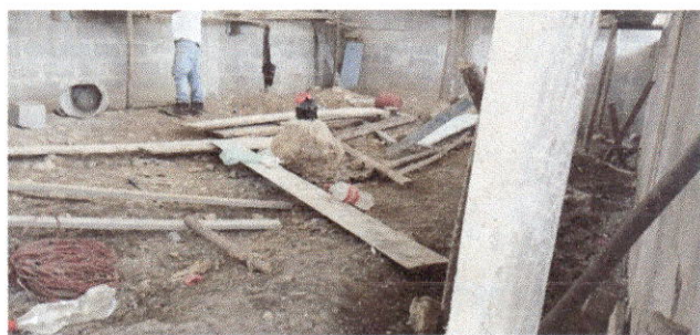
Foto 3: Piso; pendiente de tirar la torta de cemento
